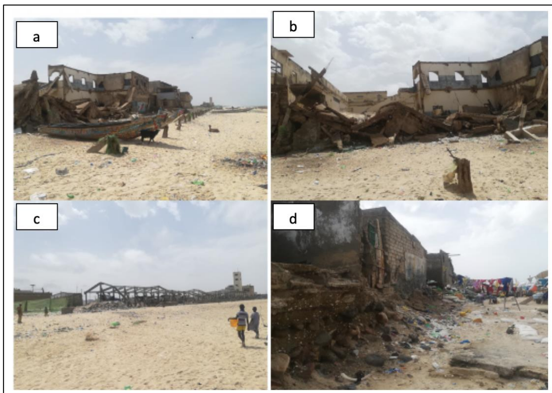
Fig. 9 : Impacts du recul du trait de côte sur le bâti à Guet-Ndar
