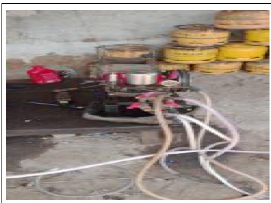
Fig.3 : Dispositif de transvasement du gaz butane
