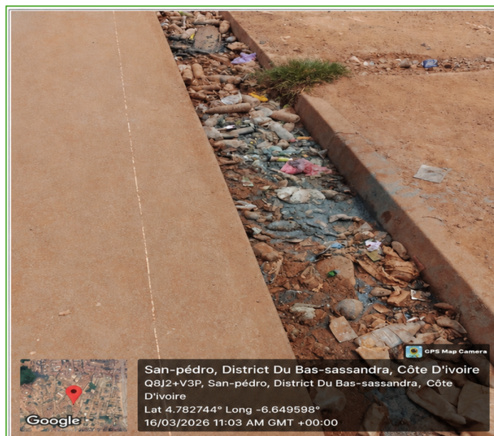
Fig. 5 : Accumulation de déchets solides dans les caniveaux à Soleil
