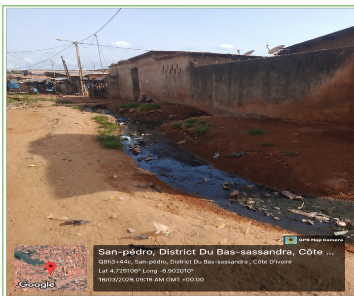
Fig. 6 : Absence de canaux d'évacuation des eaux usées au Château
